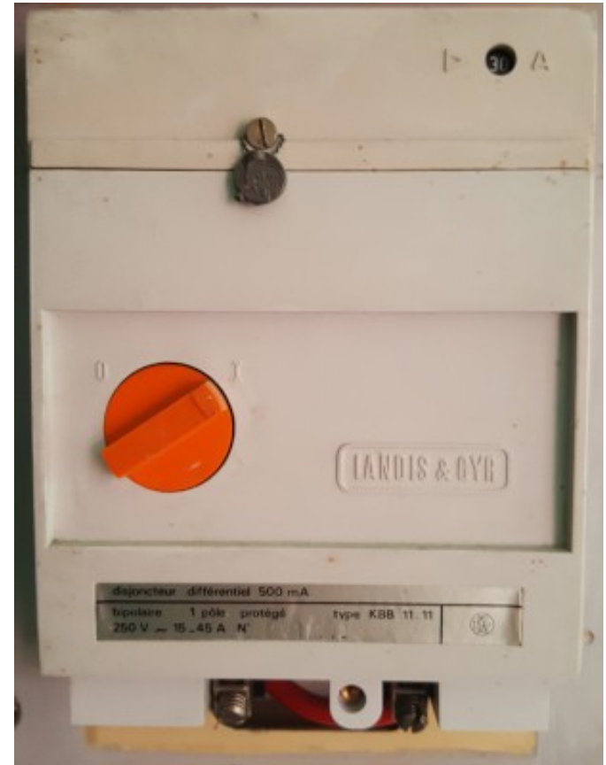
Ancien disjoncteur différentiel à 500 mA
